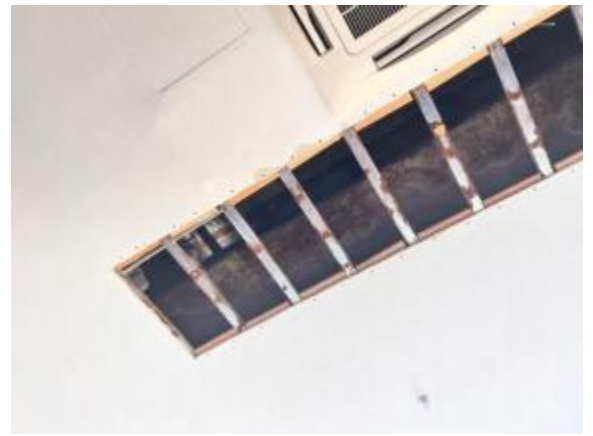
照片 10：屋面钢梁锈蚀
