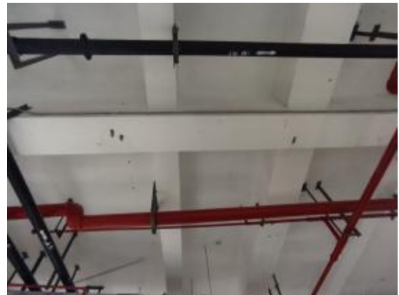
照片 4：地下室顶板锈蚀、保护层脱落
