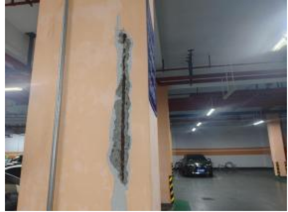
照片 2：地下室柱体锈蚀、保护层脱落
