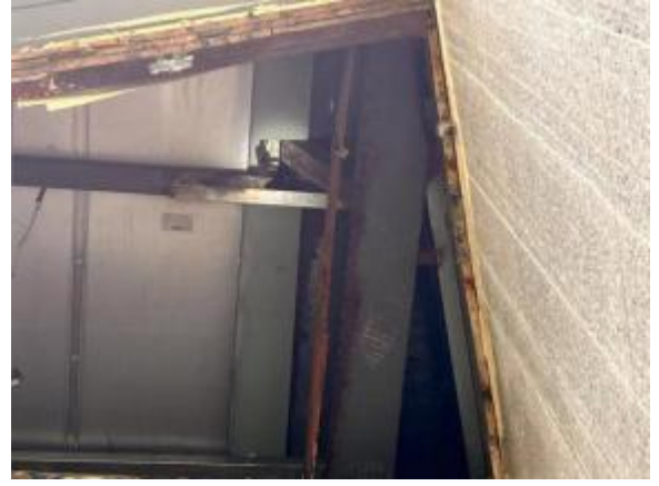
照片 8：一层顶板钢结构锈蚀
