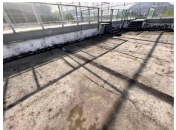
照片 18: 屋面地坪开裂
