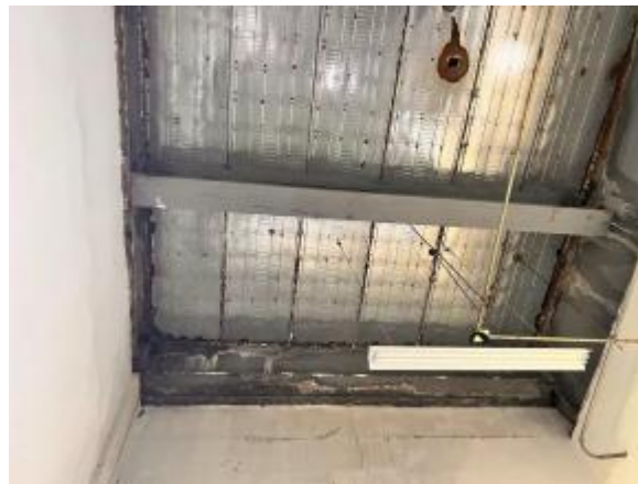
照片 11：屋面钢梁锈蚀
