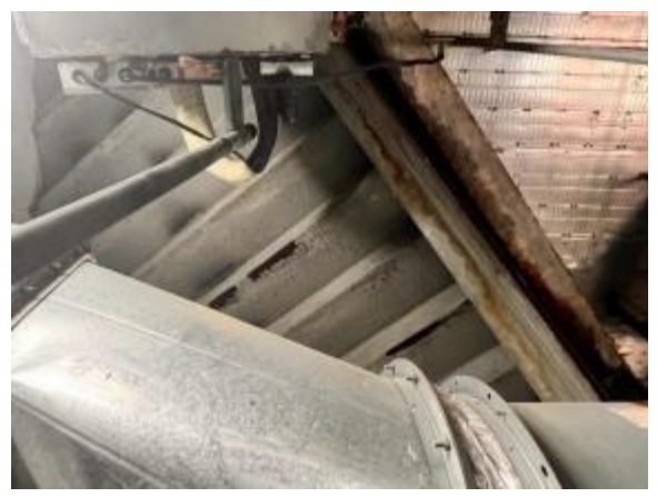
照片 14: 钢构件连接节点锈蚀
