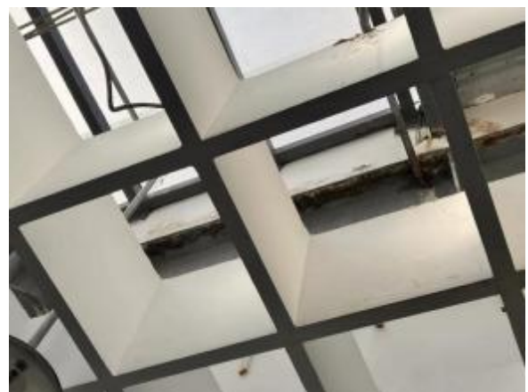
照片 12：屋面钢梁锈蚀
