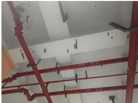
照片 3：地下室顶板锈蚀、保护层脱落
