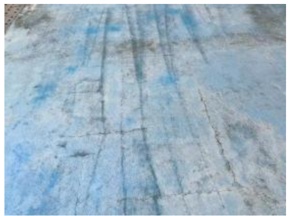
照片 17: 屋面地坪开裂
