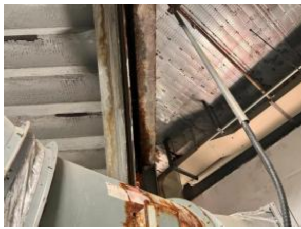
照片 13: 钢构件连接节点锈蚀
