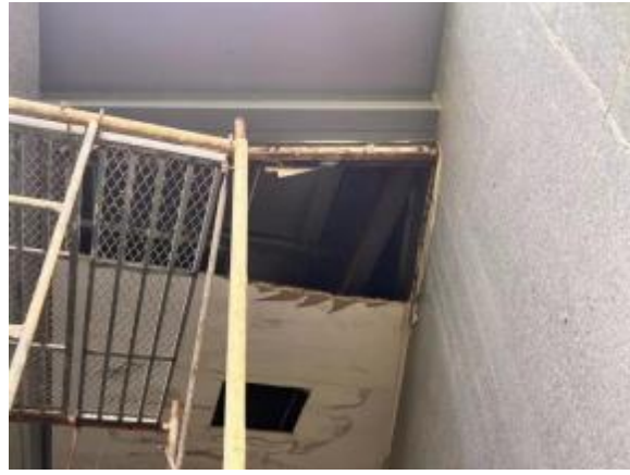
照片 7：一层顶板钢结构锈蚀
